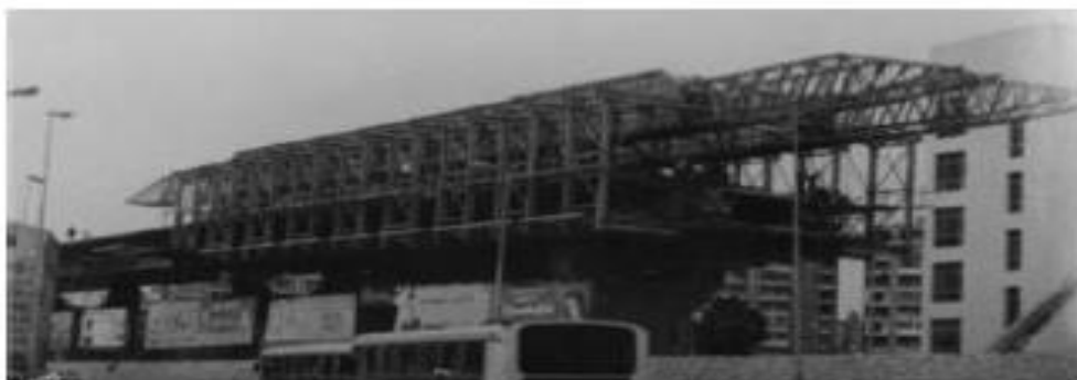
Rasm 12.7 Montaj fermalari va tayanch ramalaridan foydalanib oraliq qurilmani betonlash (6 – oktyabr ko'prigi)
