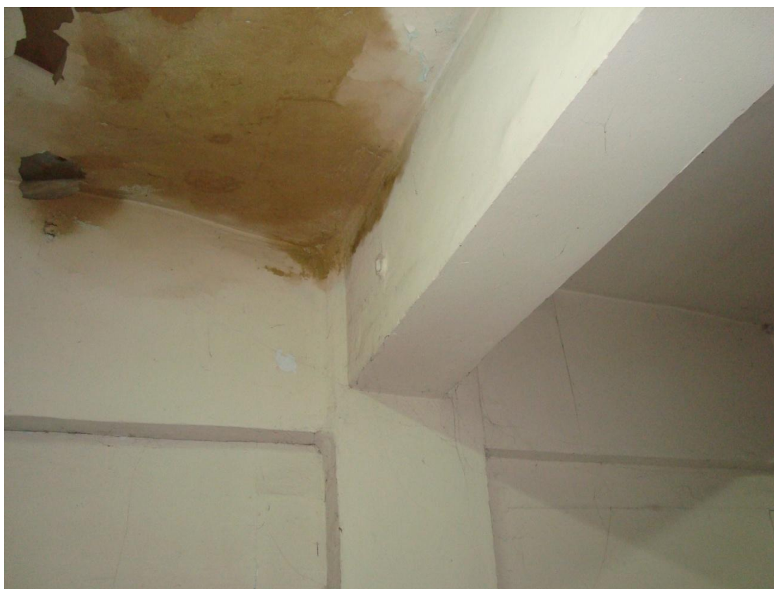
Рис 2.6 сопряжение элементов ребристого ж-б перекрытия и следы протечек
