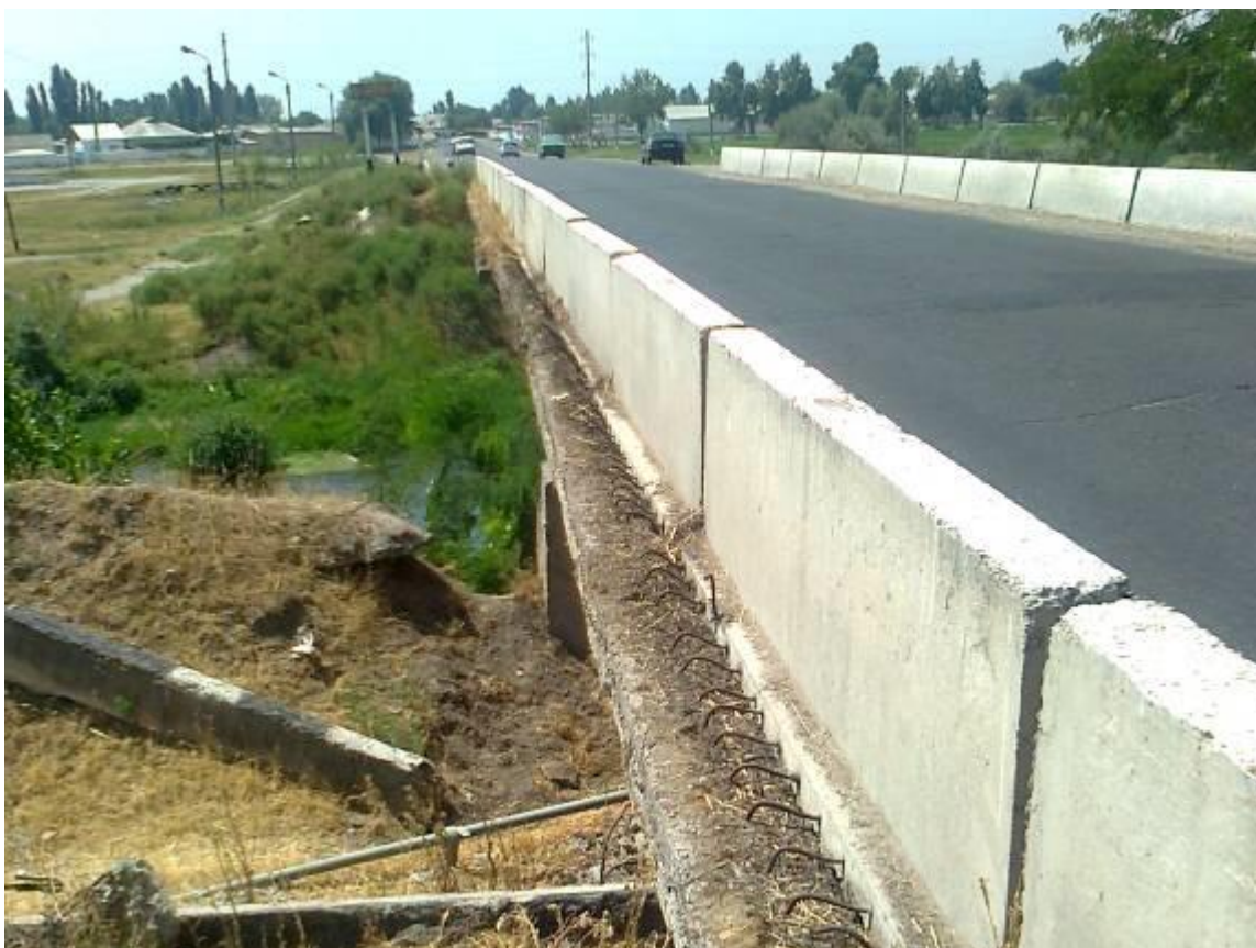
Фото 6. Вид моста сверху. С правой стороны моста отсутствуют тротуарные плиты.
