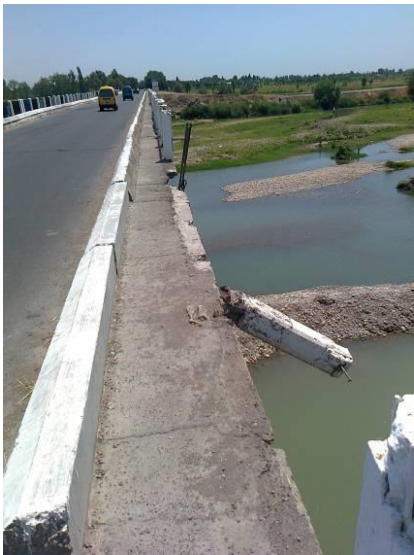
Фото 14. Вид на тротуарные плиты моста. Часть стоек и перил выпали.
