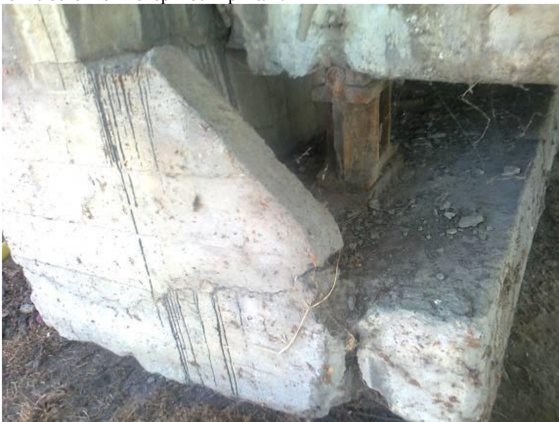
Фото 5. Вид устоя №3. Наблюдаются сколы бетона, потеки и шелушение бетонной поверхности ригеля и откосного блока.
