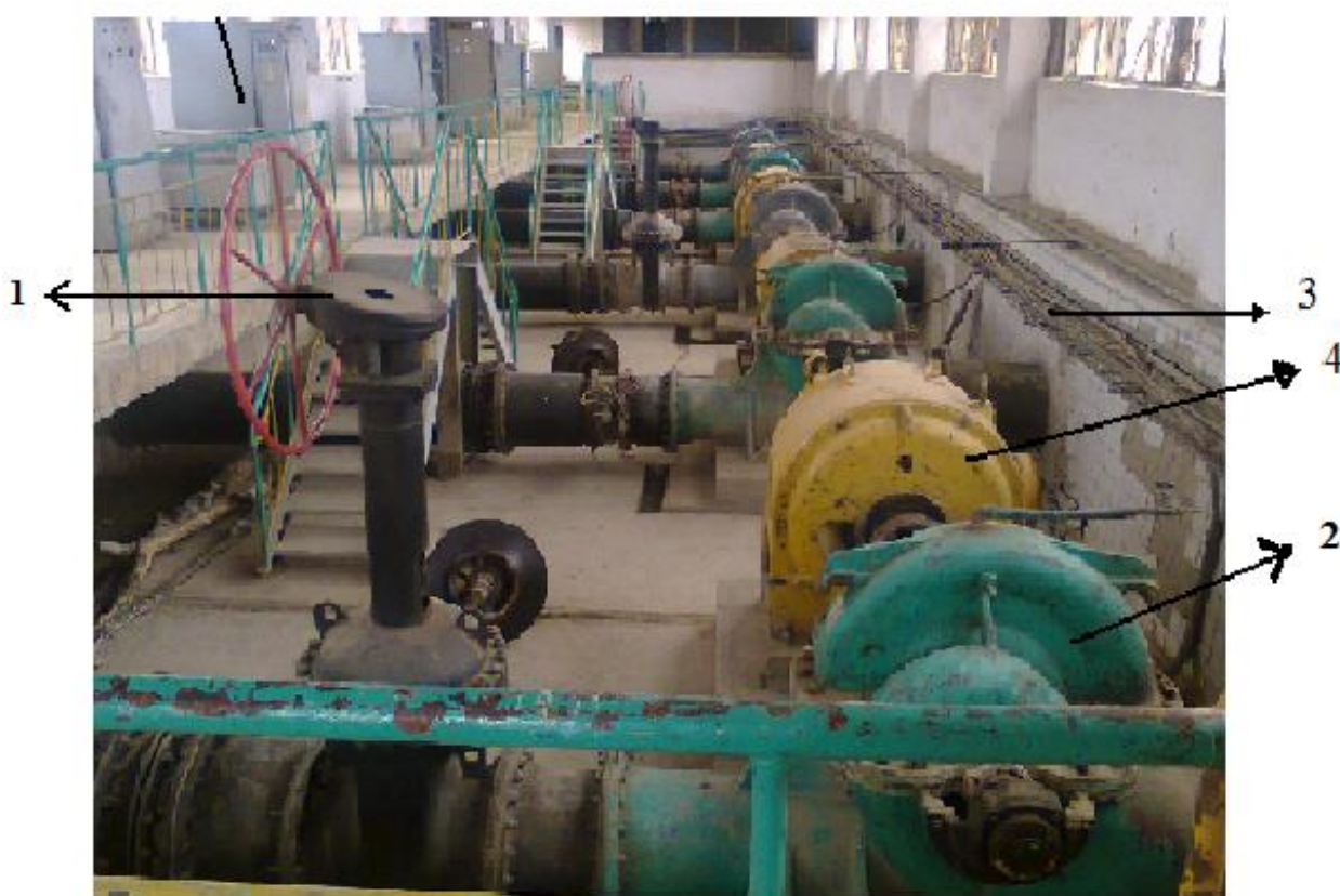
1.1-расм. “Тосс” насос станциясининг кўриниши.
