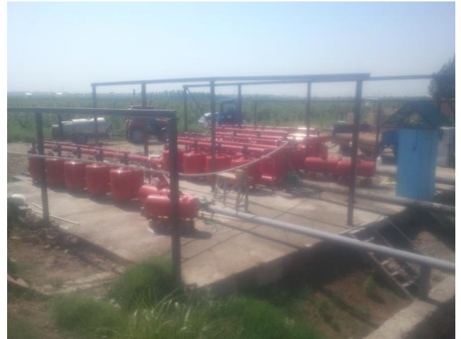
Rasm-6. SIU ning umumiy ko'rinishi
