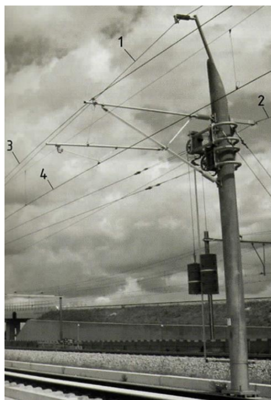
11.4-rasm. Gollandiyadagi Belgiya bilan chegaradosh Amsterdam-Rotterdam uchastkasida o'rnatilgan Siemens firmasining SICAT H1.0 kontakt tarmog'i
