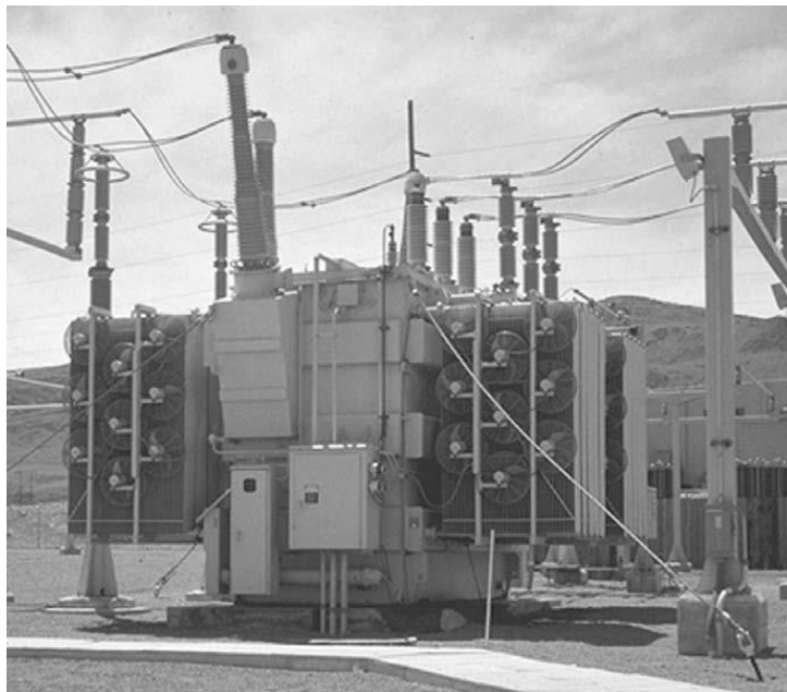
99-расм. Пасайтирувчи трансформатор.
