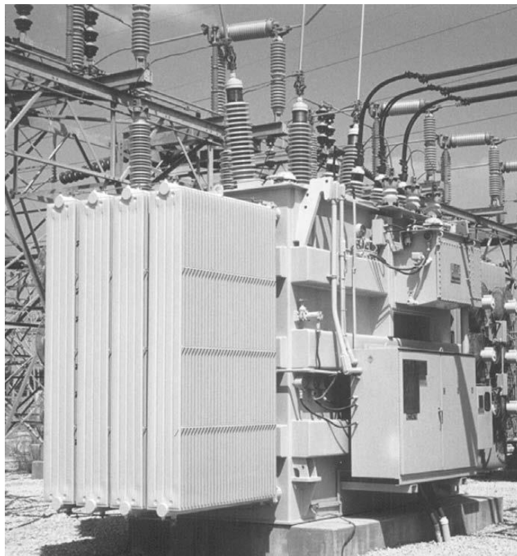
100-расм. Таксимловчи куч трансформатори
