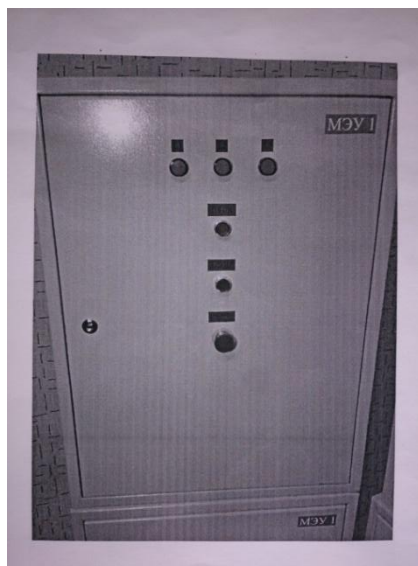
15.3-rasm. Nasos agregatining asinxron elektr yuritmasini boshqarish uchun 110 kVt quvvatli elektr tejamkor qurilma umumiy ko‘rinishi
