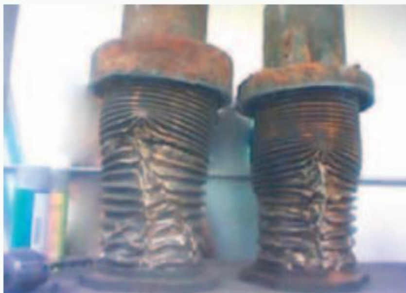
Рис. 2. Компенсаторы, разрушенные из-за внезапного закрытия клапана
