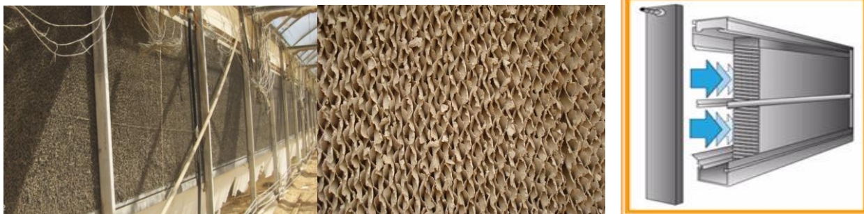
30- rasm. Qovurg‘ali sovutgich (gofra) va Konditsioner (Pad & Fan).
