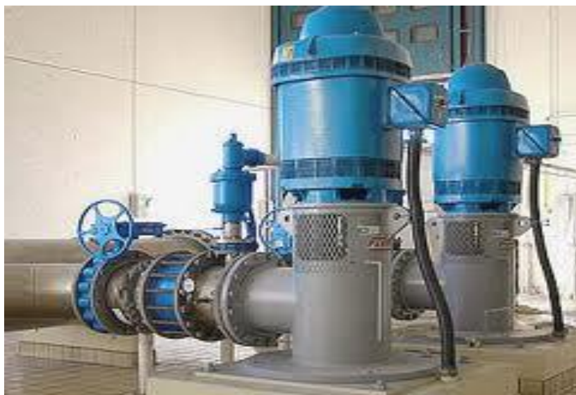
9-расм. Ер ости сувларини узатиш насос станцияси
