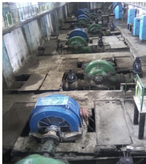
2-расм. Пахтакор насос станцияси
