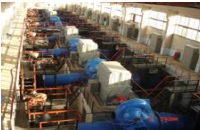
7-расм. Сув узатиш насос станцияси
