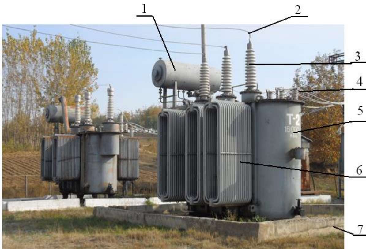
14 - расм. Кучланиши 110/6 кВ ли қуввати 16000 кВА, ТДН-16000/110-У1 мой трансформатори
