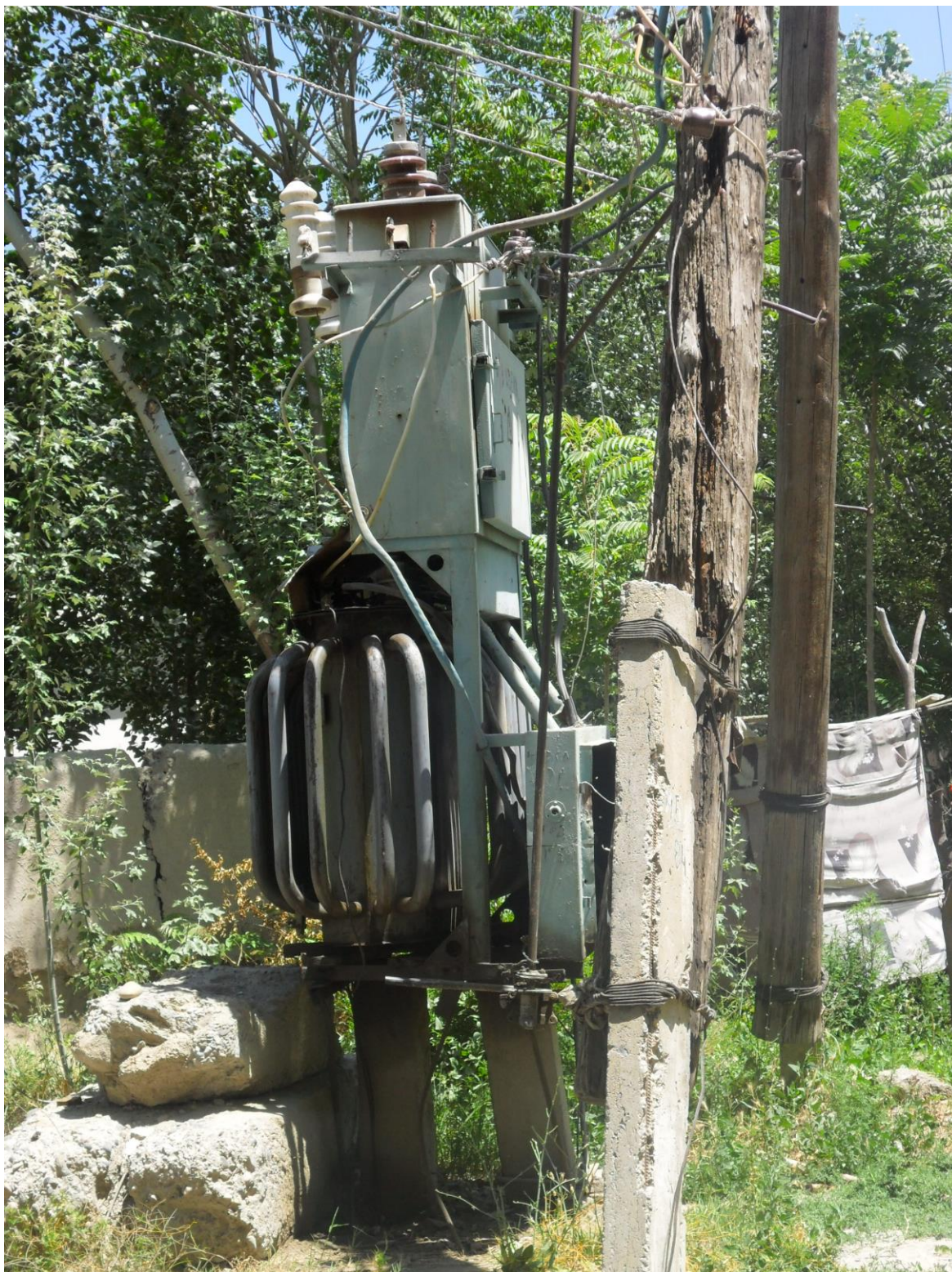
5 - расм. Аҳоли турар жойларини электр энергияси билан таъминлаш учун ўрнатилган №6 сон 10/0,4 кВ ли ТМ 100 кВА ли трансформатор пункти.
