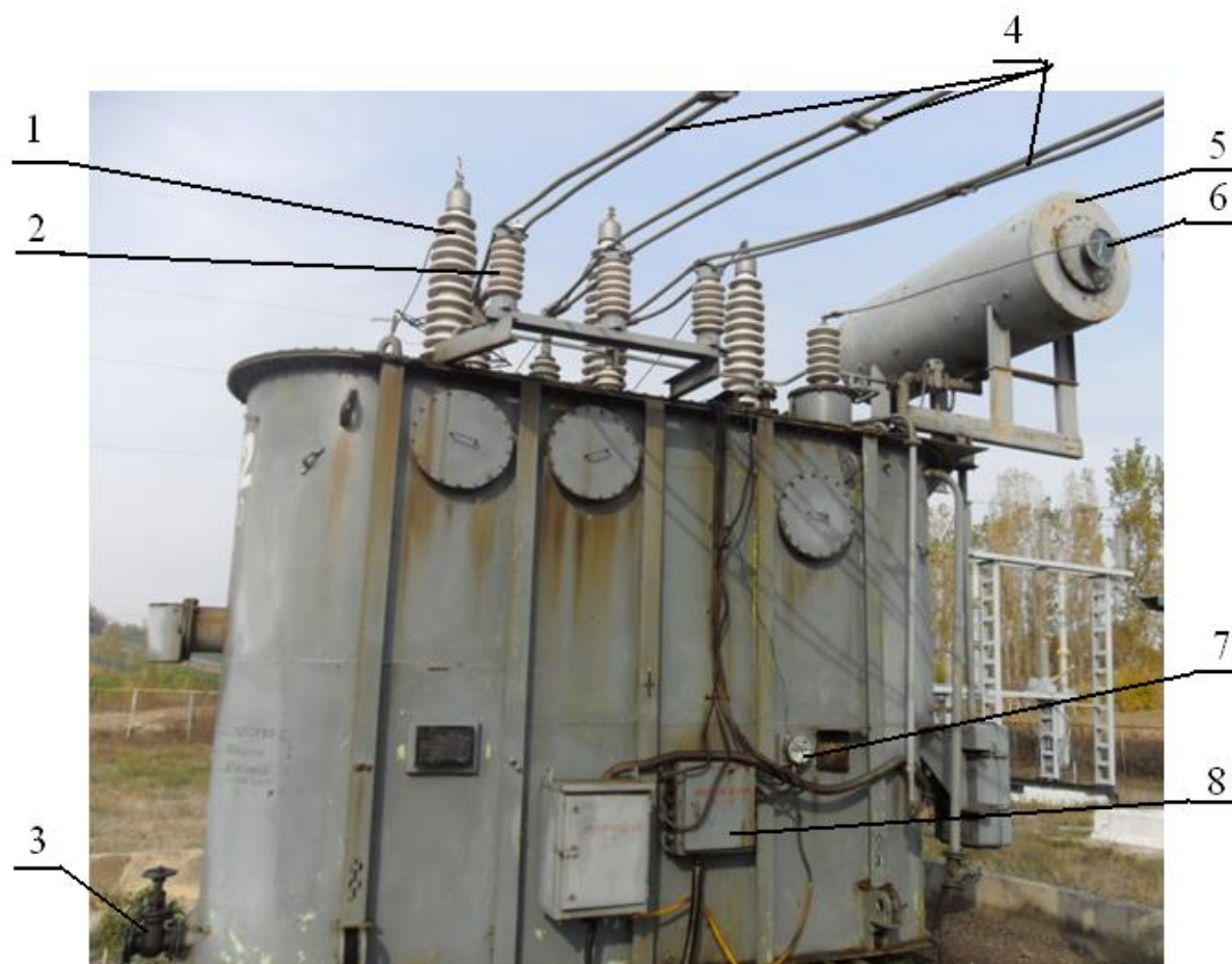
15 - расм. Кучланиши 110/6 кВ ли қуввати 16000 кВА, ТДН-16000/110-У1 мой трансформатори
