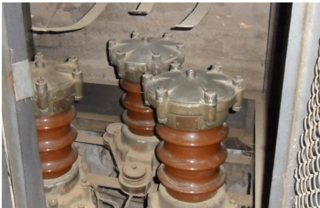
2.5. – расм. РВВ 6 разрядлагичнинг КСО272 шкафида жойлашуви.
