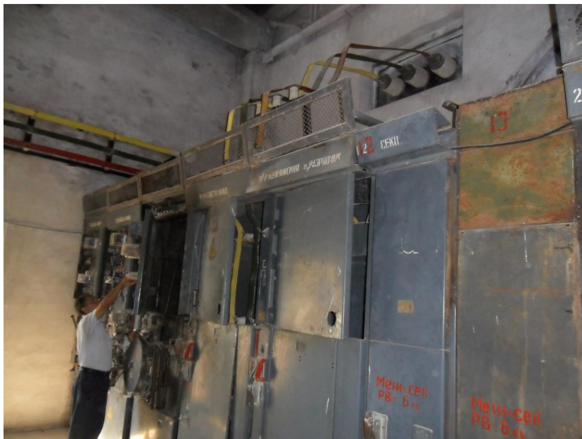
1-расм. Кучланиши 6 кВли тарқатиш қурилмалари насос станцияси ичида жойлашуви.
