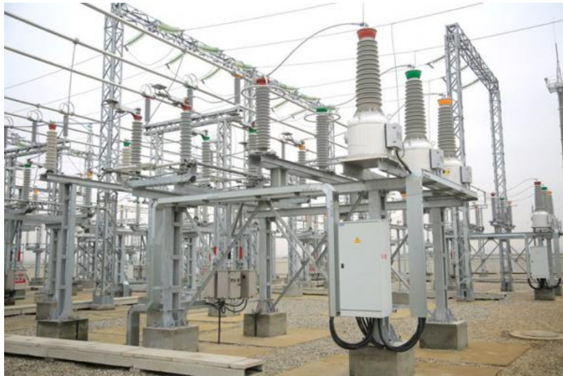
1-rasm: Ishlab chiqarilgan elektr tokini qabul qiluvchi birlamchi stansiya
