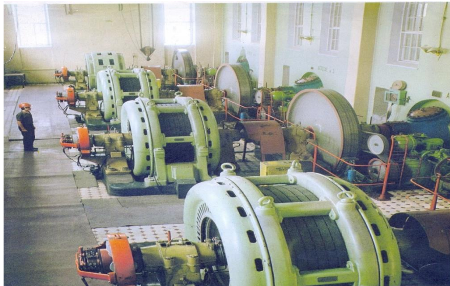
1-rasm. O'zbekistonda eng birinchi qurilgan Bo'zsuv GESining gidrogeneratorlar zali.
