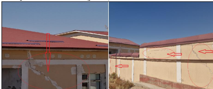
Рис. 1. Трещинообразование в здании и перегородочной стене на окраине г.Зарафшан
