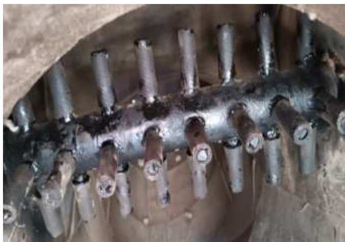
Рисунок 17. Колковый барабан с эластичным покрытием, установленный на входной трубе камнеуловительного устройства
