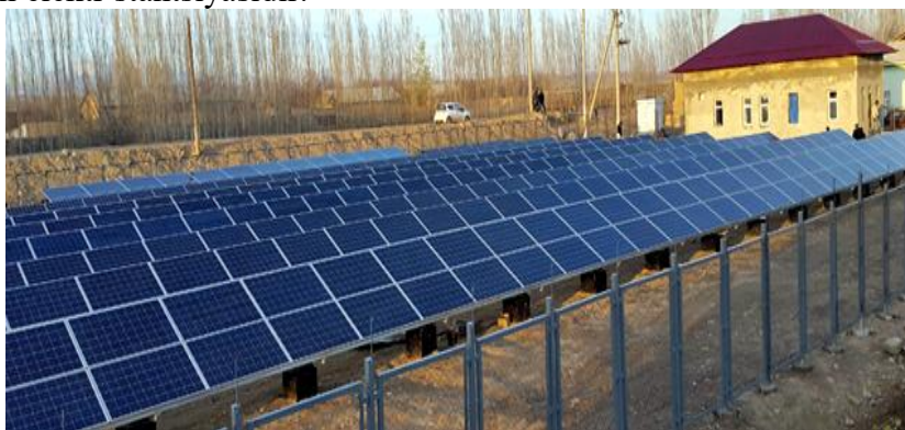
13.3- rasm. Mamlakatimizdagi birinchi, quvvati 140 kVt bo'lgan quyosh elektr stantsiyasi.
