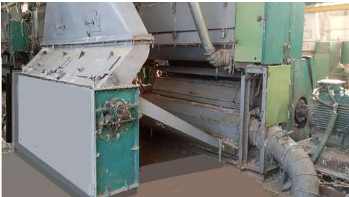
Рис. 7. Общий вид нового рекомендованного устройства очистки волокна
