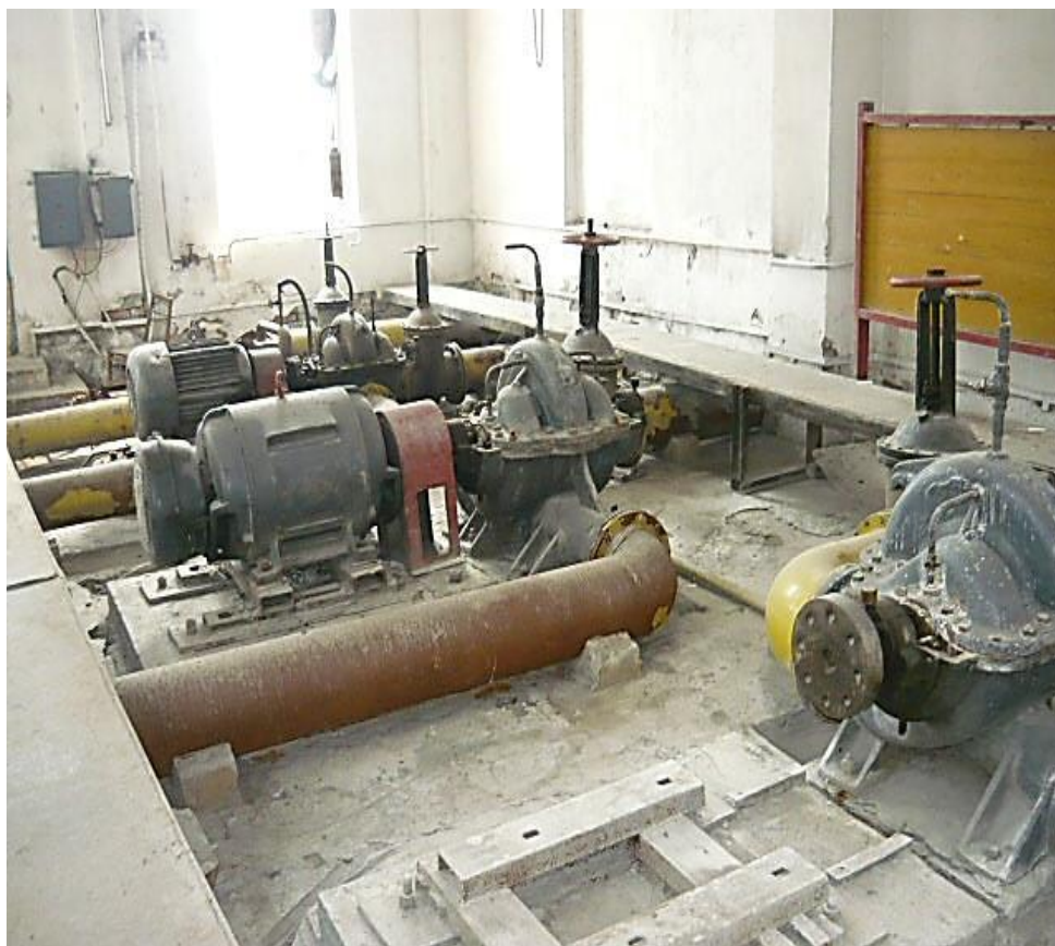
5 – расм. Саноат сув таъминоти насос станцияси.
