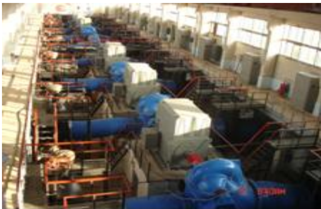
7-расм. Сув узатиш насос станцияси
