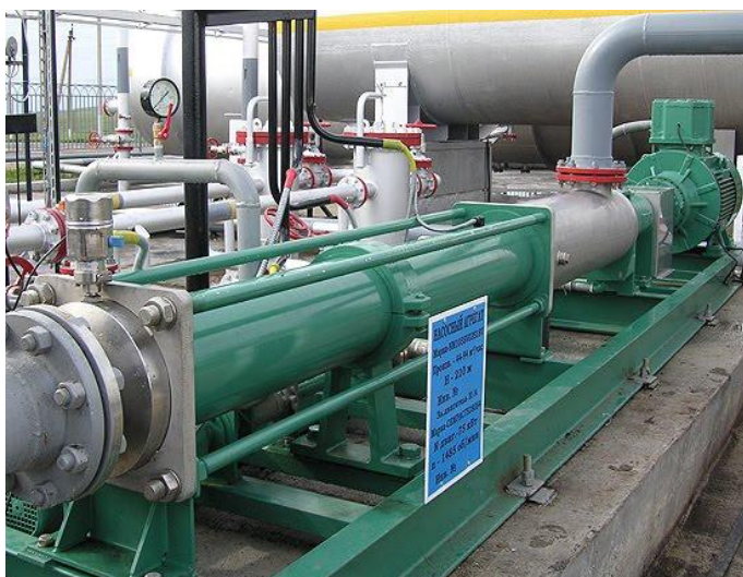
5-расм. Чўпонота насос станцияси
