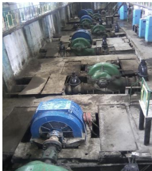
2-расм. Пахтакор насос станцияси
