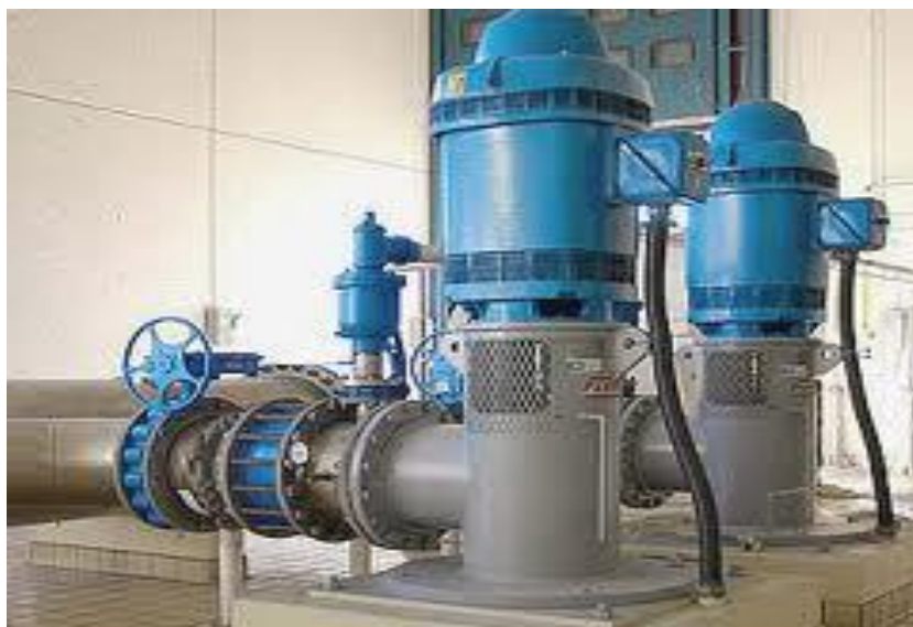
9-расм. Ер ости сувларини узатиш насос станцияси
