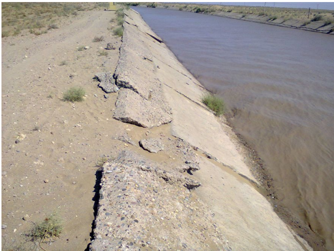
2.13-расм. Хамза-1 канали бетон қисми емирилиши
