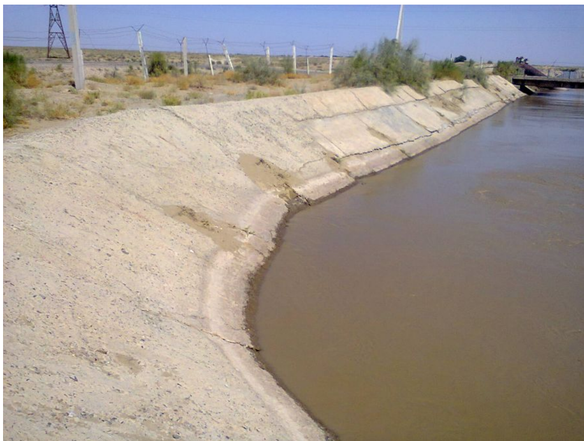
2.12-расм. Хамза-1 канали бетон қисми емирилиши
