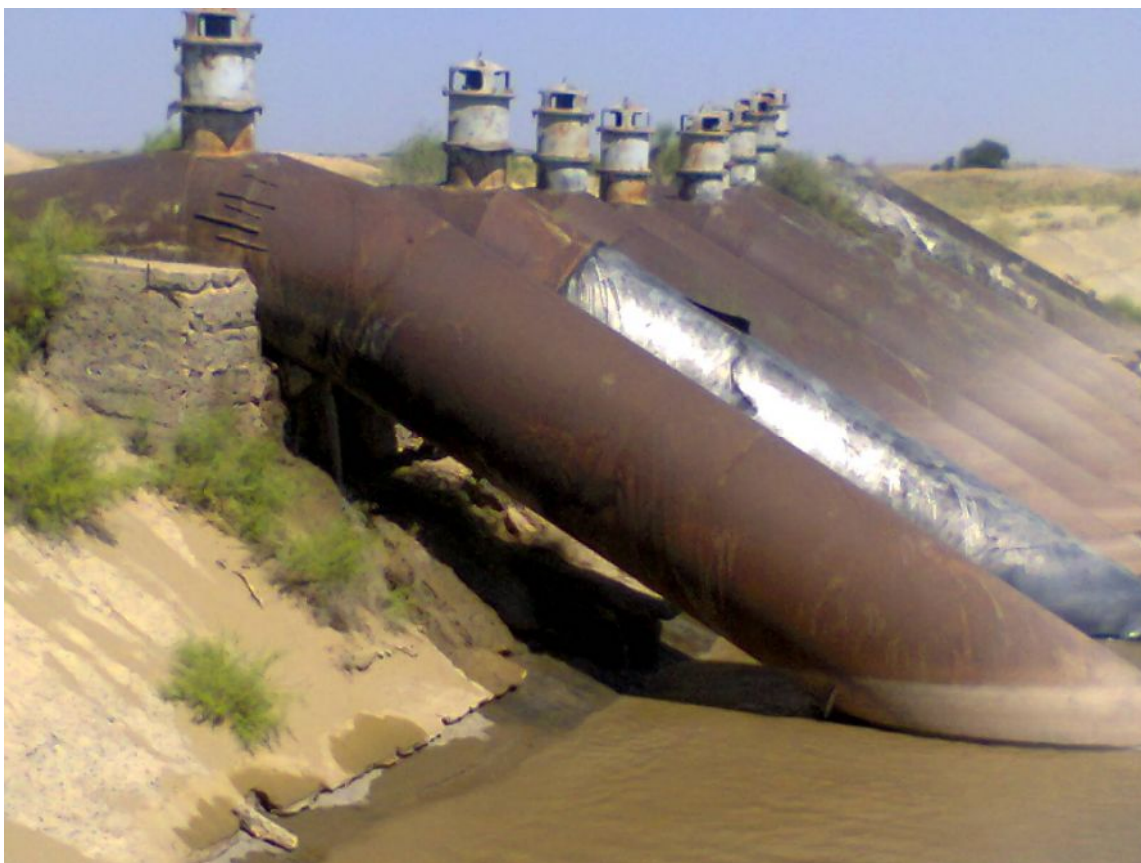
2.14-расм. Хамза-1 насос станцияси қувурлари (таъмирталаб)
