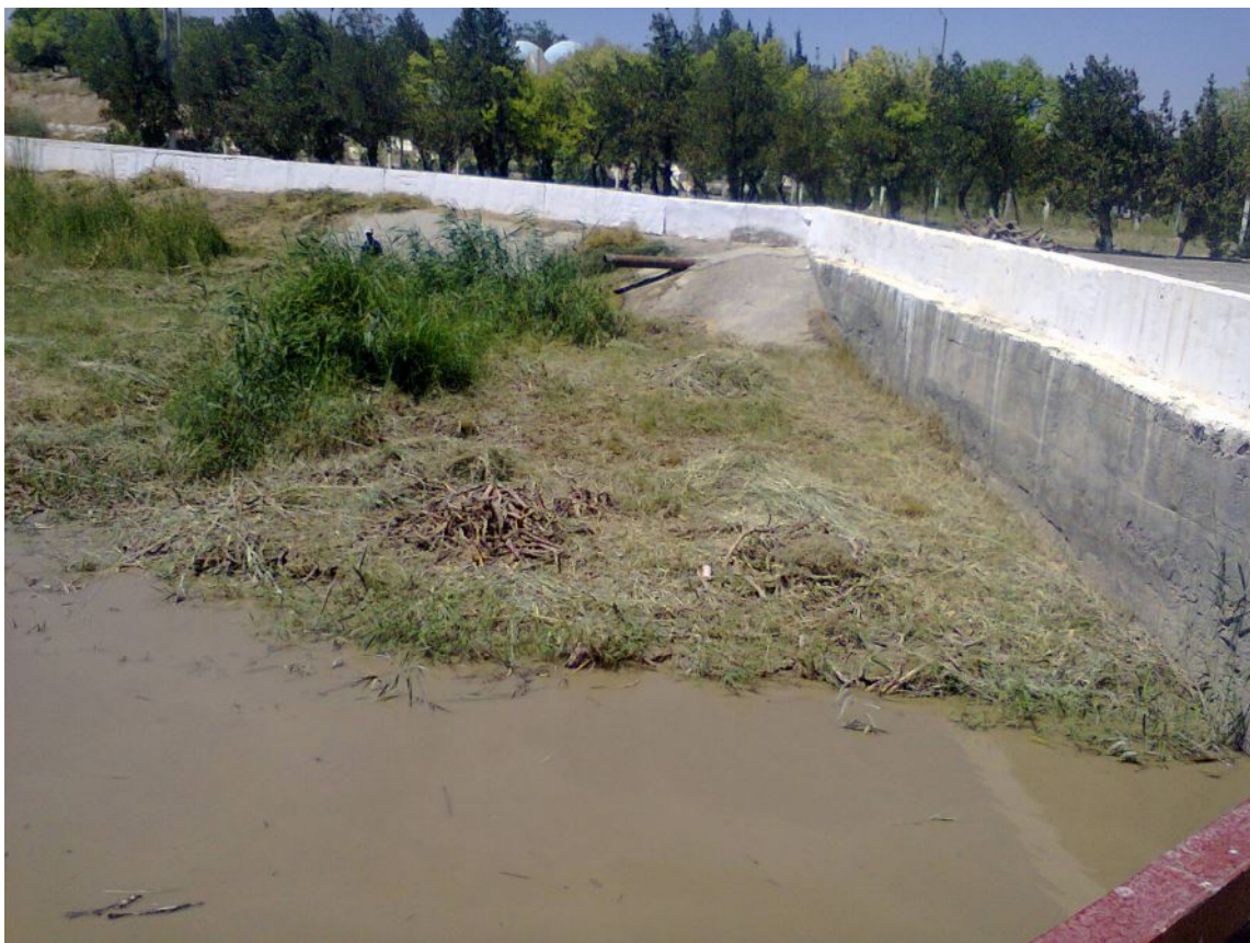
2.17-расм. Хамза-2 насос станцияси пастки бьефидаги лойқа чўкиш
