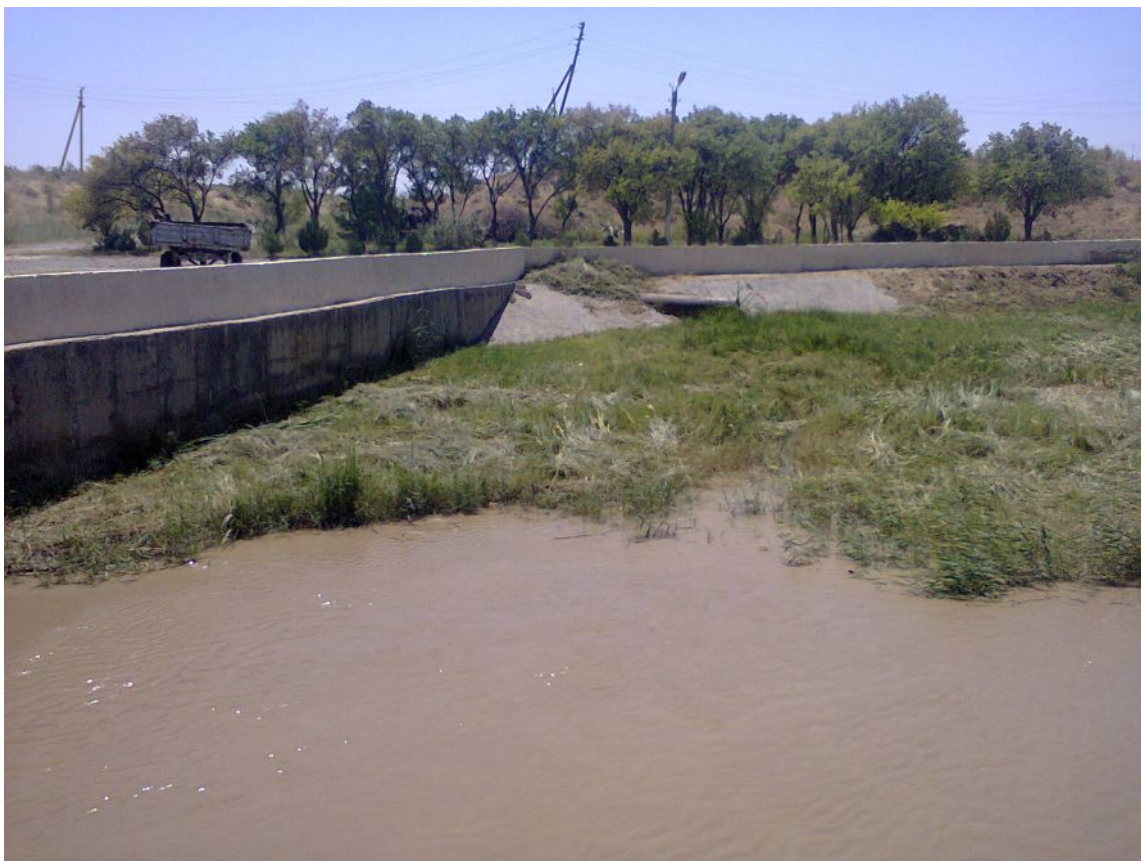
2.19-расм. Хамза-2 насос станцияси пастки бьефидаги лойқа чўкиш
