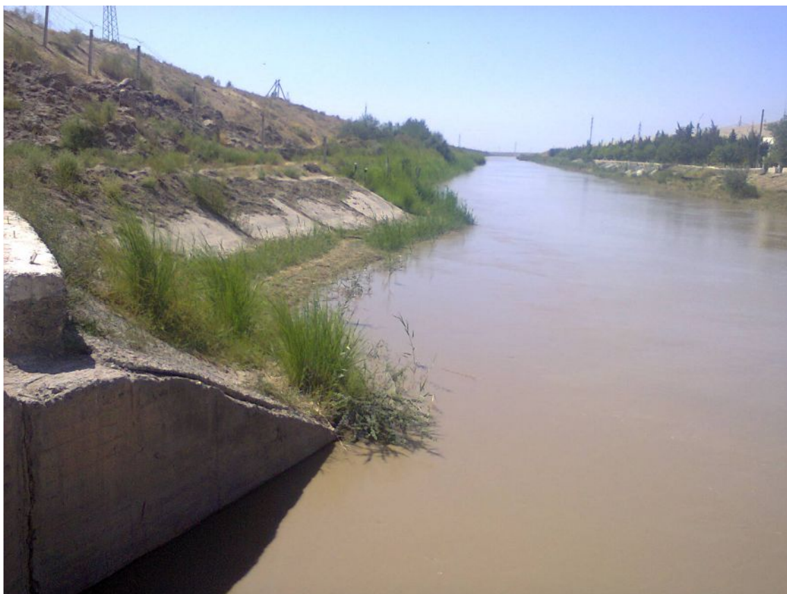
2.10-расм. Хамза-1 насос станцияси олдида лойқа ўтириши
