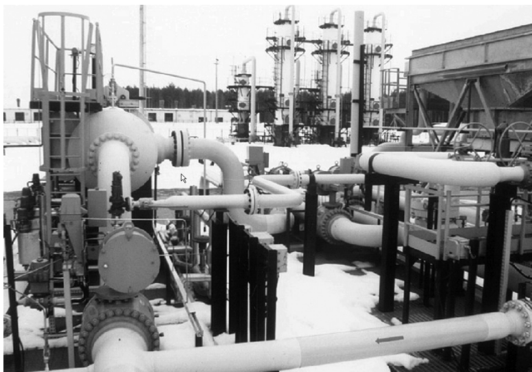
1.5-rasm. Kompresor stansiyasi.
