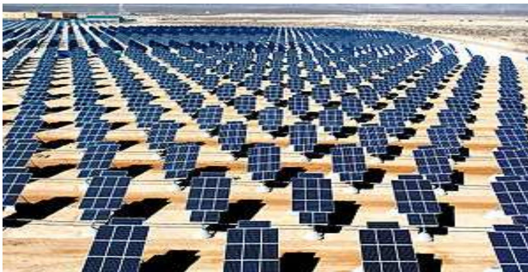
2.6.-rasm . Quyosh panellarining umumiy ko'rinishi.
