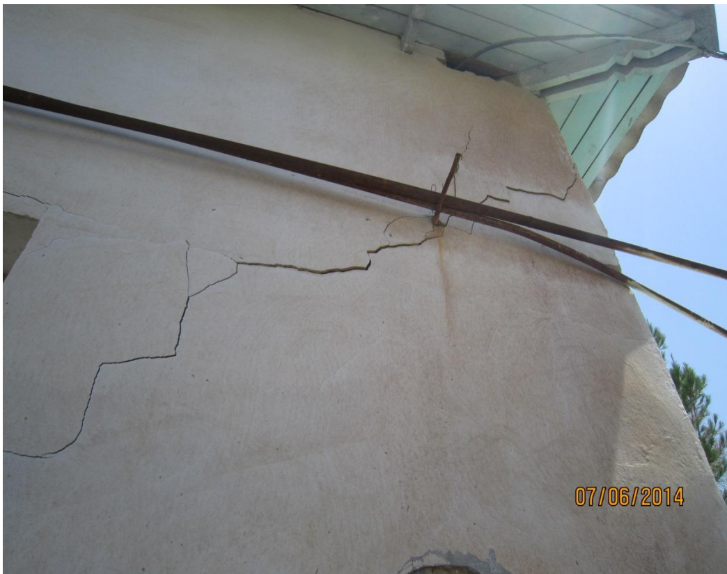
Фото 16. Дефекты в конструкции
