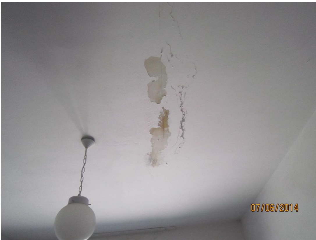
Фото 19. Дефекты в конструкции
