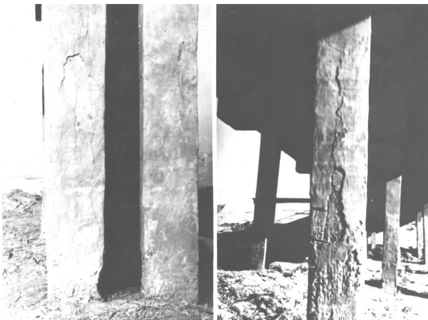
8—расм . Қозиқ—эстакадали кўприклардаги бетоннинг ишқорланиши ва ёрилиши
