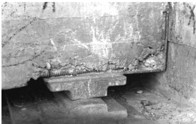
9—расм . Темирбетон оралиқ қурилмасининг тангенциал таянч қисми асоси остки ва устки ўқларининг силжиши, тўсин ишчи арматурасининг очилиб қолиши
