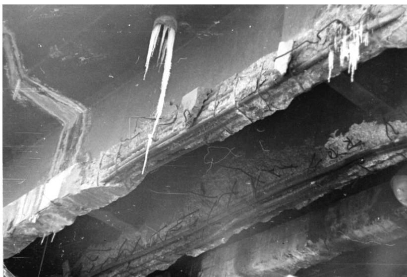
12–расм. 3376 км даги темир йўл ўтказгичи тўсини ишчи арматурасининг очилиб қолиши
