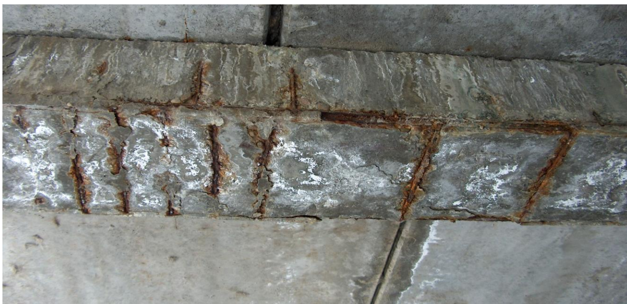
4-rasm. Rigel armaturasining himoya qatlamini buzilishi va armaturaning korroziyaga uchraganligini.
