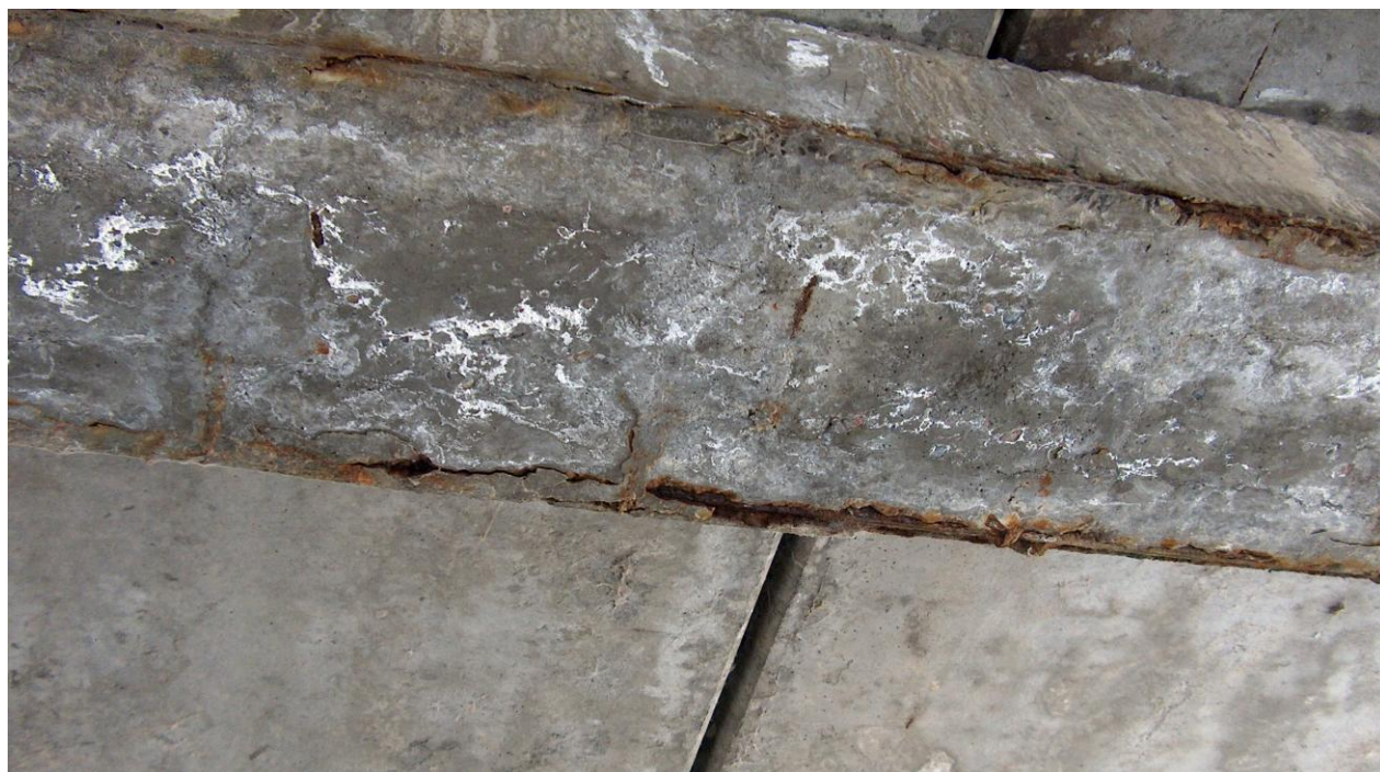
6-rasm. Rigel armaturasining himoya qatlamini buzilishi va armaturaning korroziyaga uchraganligini.
