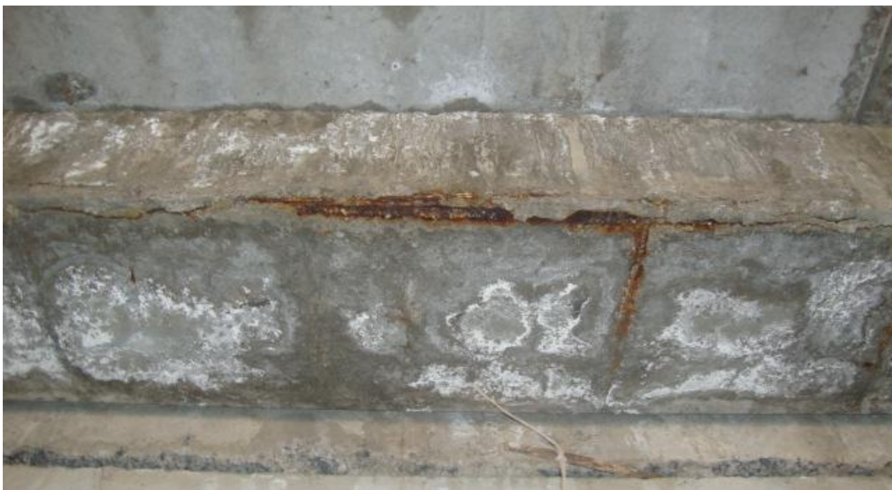
5-rasm. Rigel armaturasining himoya qatlamini buzilishi va armaturaning korroziyaga uchraganligini.
