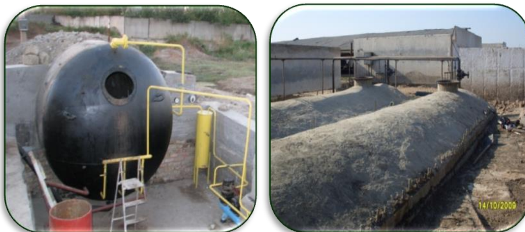
1.4– rasm. Surxandaryo viloyatidagi biogaz qurilmasi
