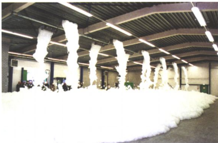
Тестовые испытания спринклерной установки
