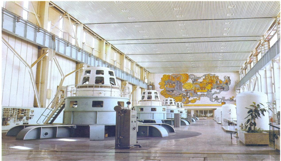
4.3– rasm. Farhod GES ning gidrogeneratorlar zali .
