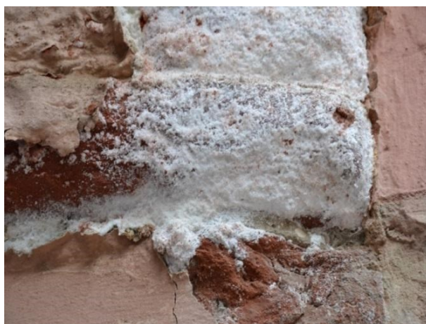
Рис. 1 Образование высолов на стенах зданий
