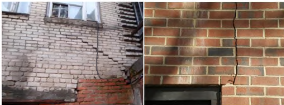
Рис.1. Трещины в кирпичных стенах эксплуатируемых жилых зданий
