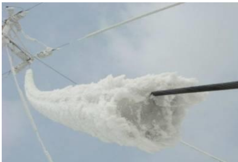
Рис. 2. Характерное обледенение провода ЛЭП
