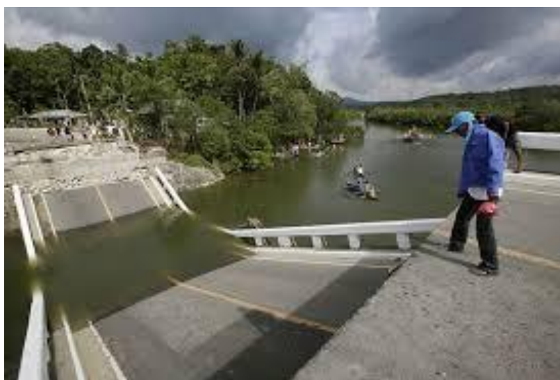
Рис.1.3. Повреждение моста в результате землетрясение 7.2 балла по шкале Рихтера
