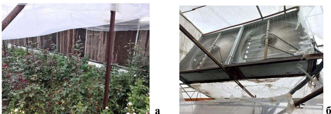
Рис. 16. Влажные маты (а) и вентиляторы (б) системы испарительного охлаждения теплицы хозяйства ООО “Sherobod sabzavot”
