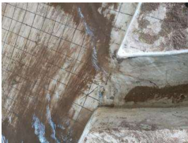
Рис. 8. Накопление наносов на входе бесплотинного водозабора
