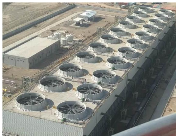
Рис. 2. Водяная охлаждающая башня (градирня)
