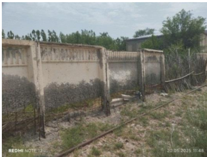
Рис. 1. Характер разрушения железобетонного барьера на улице Алпамис в районе города Нукус (2025 год).
