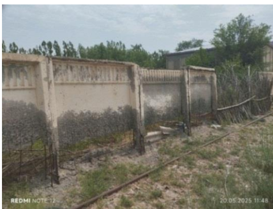
1-rasm. Nukus tumani Alpamis ko‘chasidagi temir-betonli to‘siqning emirilish xarakteri (2025yil).
