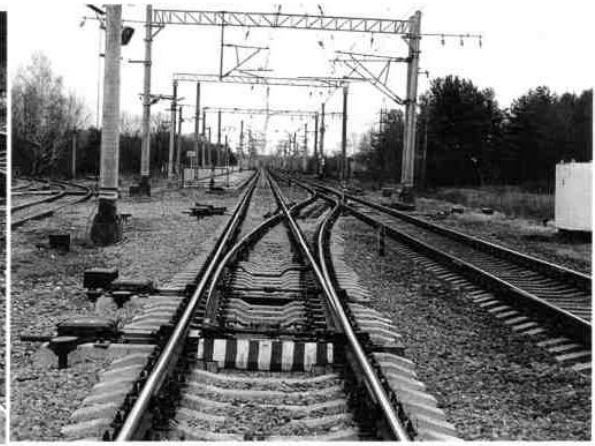
1.11 – расм. Р65 туридаги ва 1/11 маркали юқори тезликдаги ҳаракат учун стрелкали ўтказгич съезди
