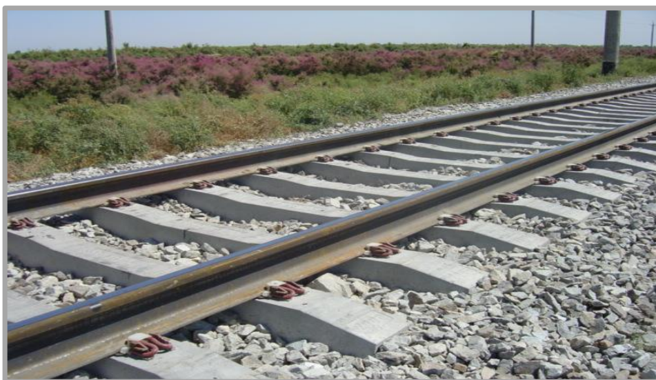
Рис. 3 Балластная конструкция верхнего строения пути на ГАЖК «Узбекистон темир йуллари»
