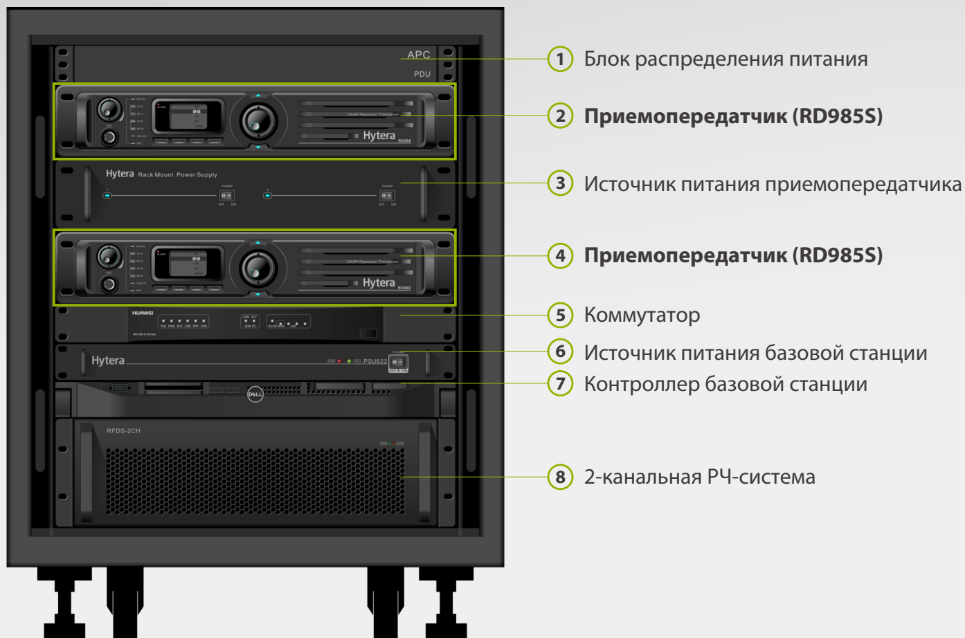
Базовая станция с 2 несущими транкинга Lite DMR
