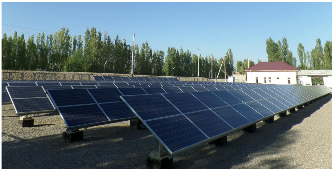
3-расм. Қуёш электр станциясининг умумий кўрениши.
