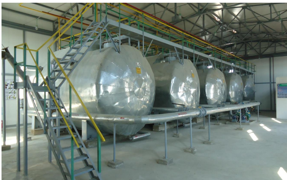
12-расм. Бухоро нефтни қайта ишлаш заводига қарашли қорамол фермасида ўрнатилган қишлоқ хўжалиги чиқиндиларига поғонали ишлов бериш қурилмаси
