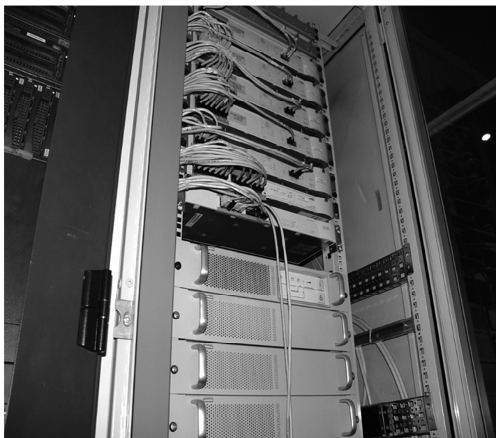
2.2-rasm. Ovoz yozishda foydalaniladigan kabellar.
