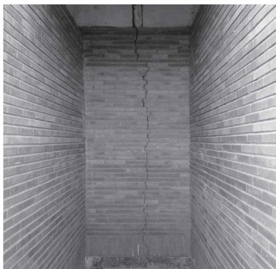
1.22-rasm. Deformatsiya chokini qo‘ymaslik oqibatida devorning yorilishiga misol.
