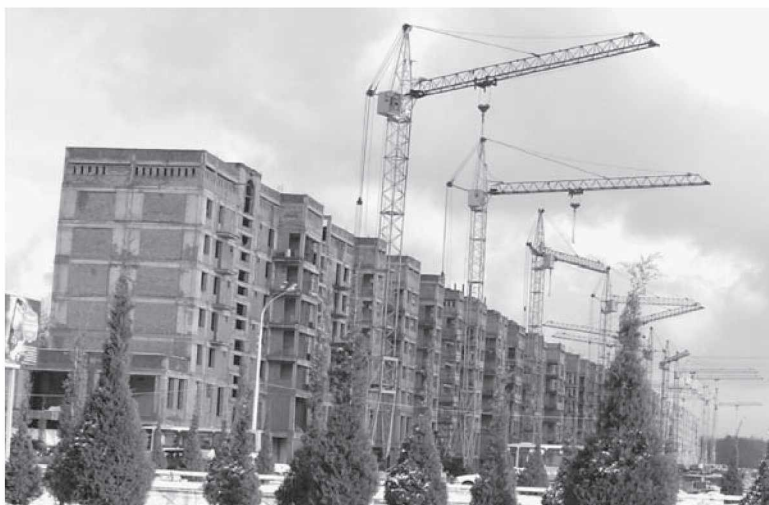
1.5-rasm. Kompleks konstruksiyalardan (sinchsiz) ishlangan Toshkentning Alisher Navoiy ko‘chasidagi zamonaviy ko‘p qavatli turar joy binolarining qurilish davridagi umumiy ko‘rinishi.
